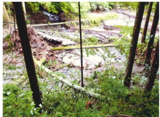
写真 4-7 台風で崩壊した 阿多野用水池と堤防
