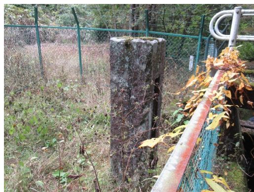
写真 4-3 崩壊した旧水門 （図解の①）
