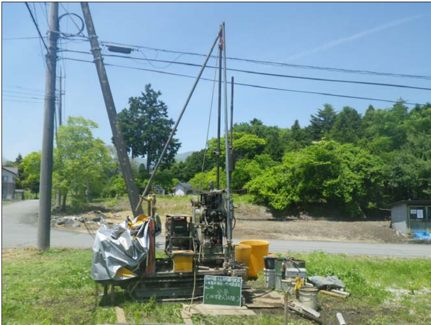
写真区分:No. 4 工種:全景 写真タイトル:全景(標準貫入試験)
