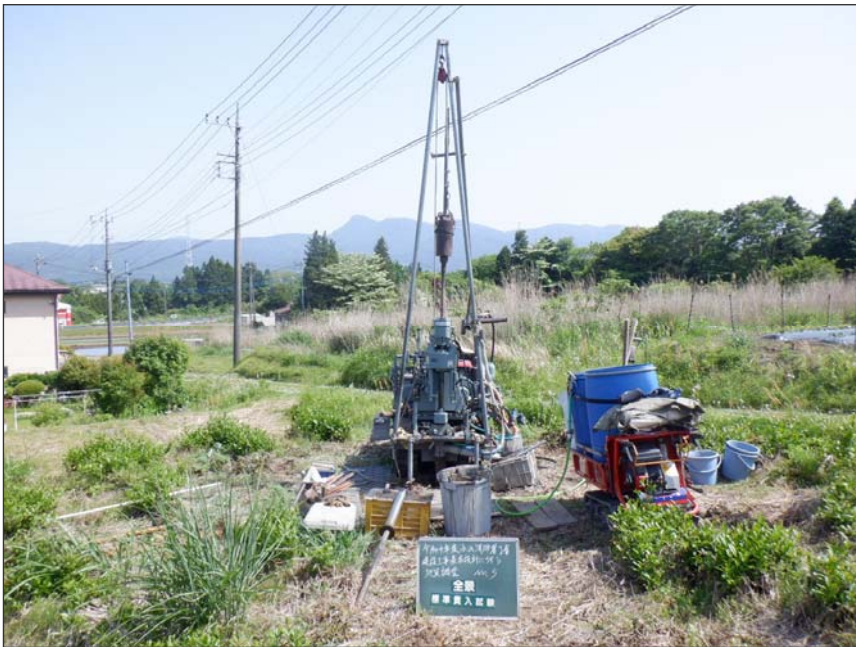
写真区分: No. 5 工種: 全景 写真タイトル: 全景(標準貫入試験)
