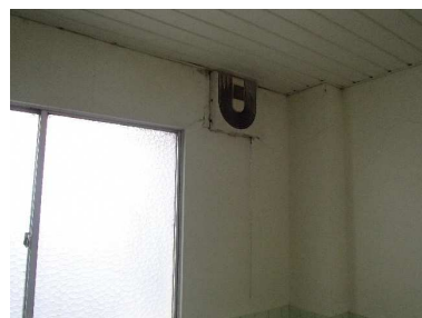
ひび割れが生じている壁
