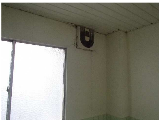
△ひび割れが生じている庁舎内壁
