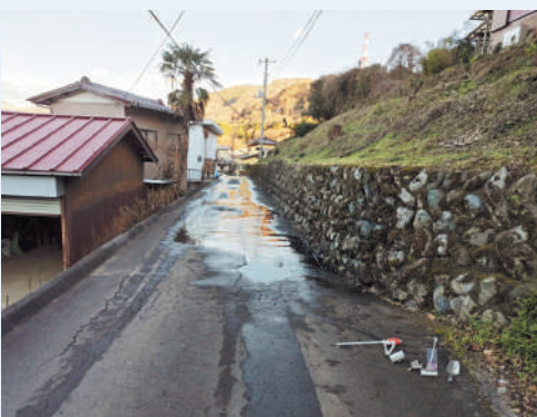
▲水道管からの漏水
