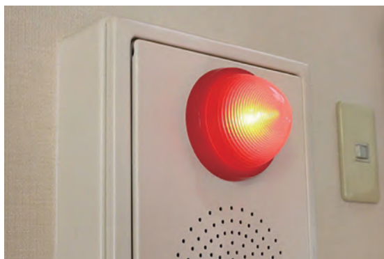
▲設置が義務付けられている消防設備
