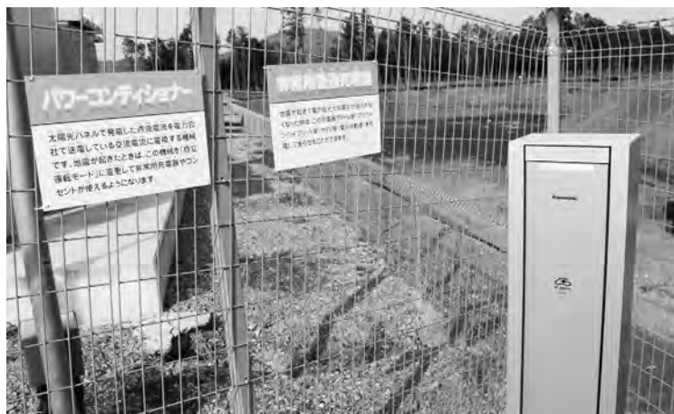
ドリームソーラーふじおやま内に設置された非常用コンセント 蓄電池などへ充電して災害に対応する(湯船)
