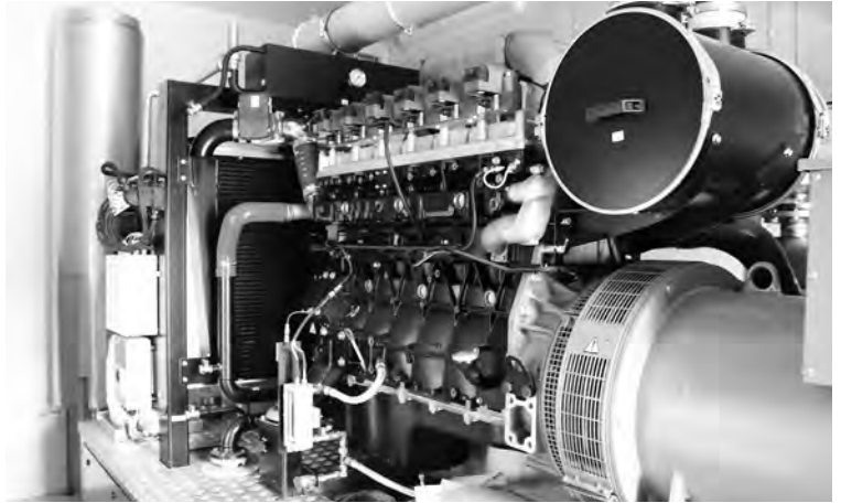
木質バイオマス発電所内に設置されたガス化エンジン(上野) 165kw/h(約40世帯分)を発電 発生した熱も供給する
