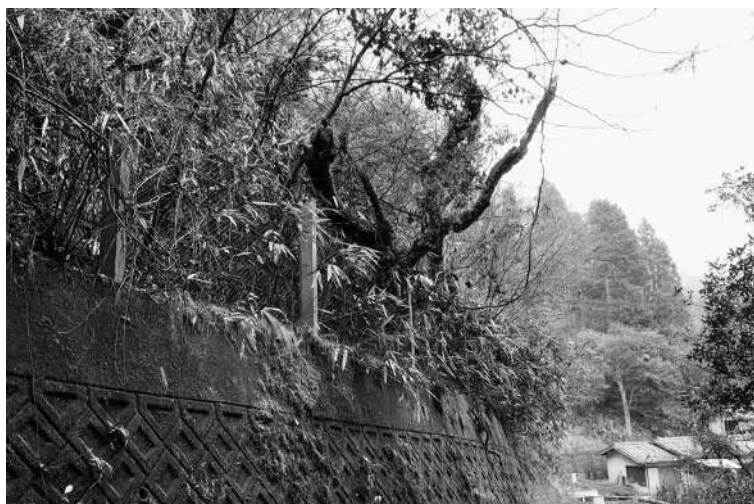
落下の危険性がある枯れ木
