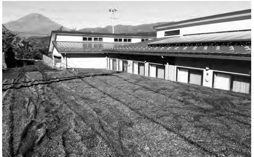
土砂流出で被害を受けた平成の杜(建物後ろ側)
