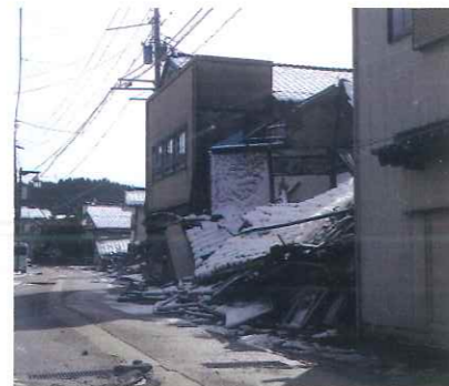
能登半島地震の被害状況
